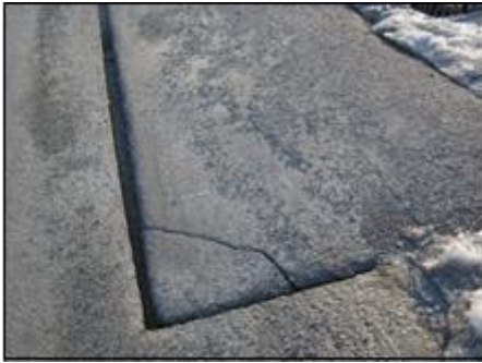
Uriktig utført asfalskjøt uten fortanning
